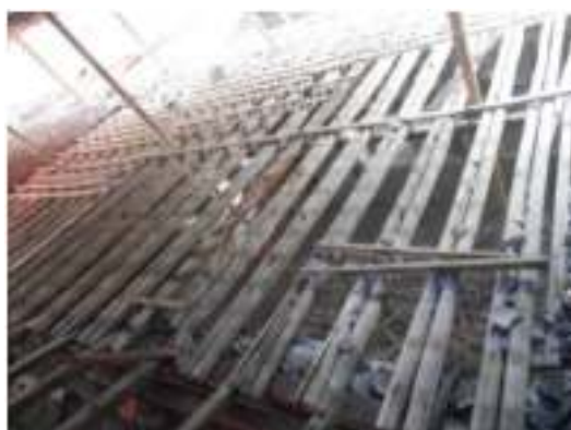
Gambar 5. Kerusakan atap bangunan Dalem Suryowijayan (Sumber: Laporan Arkeologi Rehabilitasi Dalem Suryowijayan (Susanto, Prasetyo, & Sumartono, 2017)
