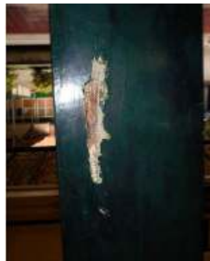
Gambar 7. Kerusakan kolom Pendapa Dalem Mangkubumen
