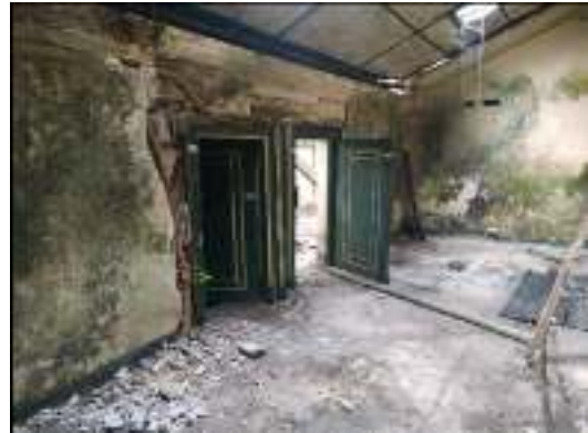
Gambar 6. Kerusakan dinding bangunan Dalem Notoprajan (Sumber: Laporan Pemugaran Rehabilitasi Dalem Notoprajan (Aloysius Wahyu, Prasetyo, & Lukito, 2021)
