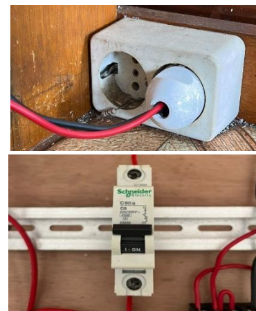
Gambar 1. Power PLN dan MCB 6A
